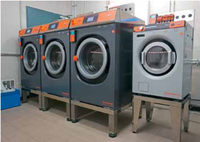
Die im Waschraum (unreine Seite) installierten Waschmaschinen vom Typ MoppWash.
